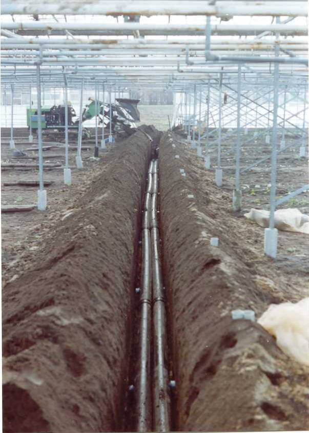
Abb. 3-27: Durch das erforderliche Gefälle der Dränagerohre liegt der SammelSchacht zwangsläufig am tiefsten Punkt. Bei längeren Häusern werden 2 Sammelrohre in der Mitte des Hauses verlegt
